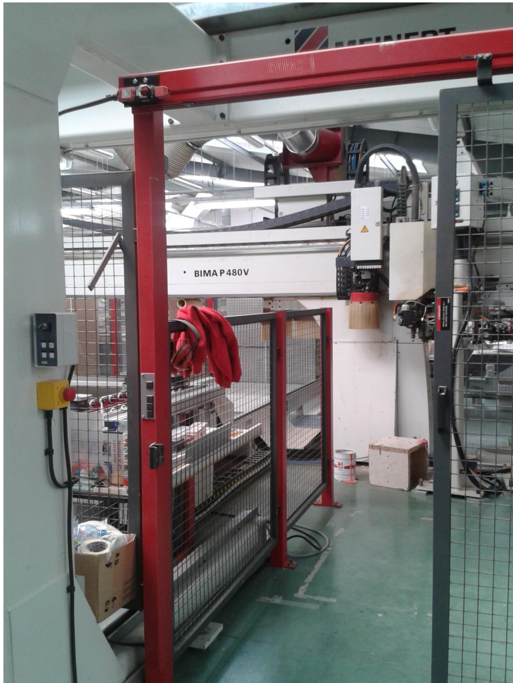
Obr. 15 Bezpečnostní dveřní spínač BERNSTEIN a tlačítko nouzového zastavení
