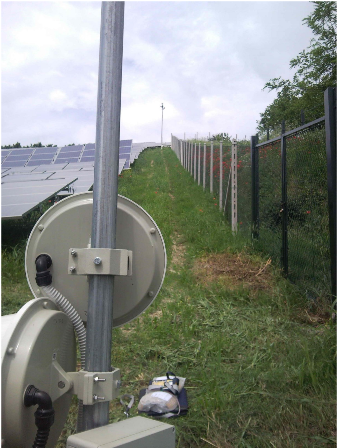
Obr. 19 Ochrana FVE pomocí MW bariér [17]
