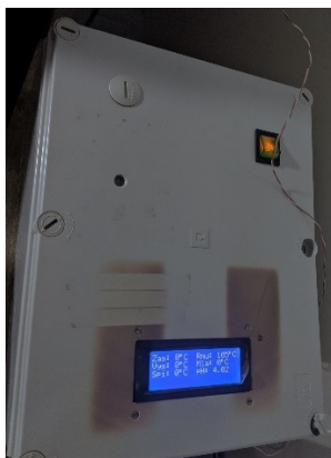
Obrázek 29 Pohledová strana rozvaděčové krabice
