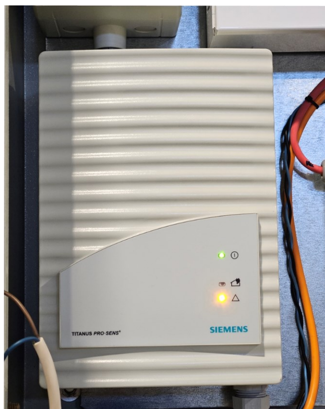
Obrázek 3: Vyhodnocovací jednotka nasávacího systému [13]
